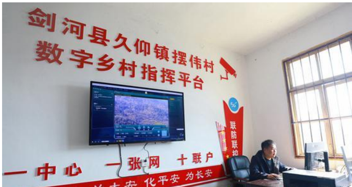
▲2024 年，贵州铁塔联合贵州移动在剑河县摆伟村投入建设“5G 数字乡村平台”。
